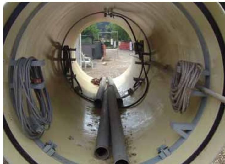
Figura 2 - Tubazioni impiegate nel microtunnel
